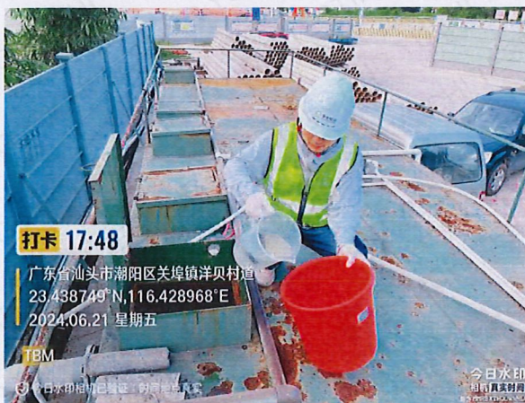
施工 5 标 TBM 隧道开端生活污水
