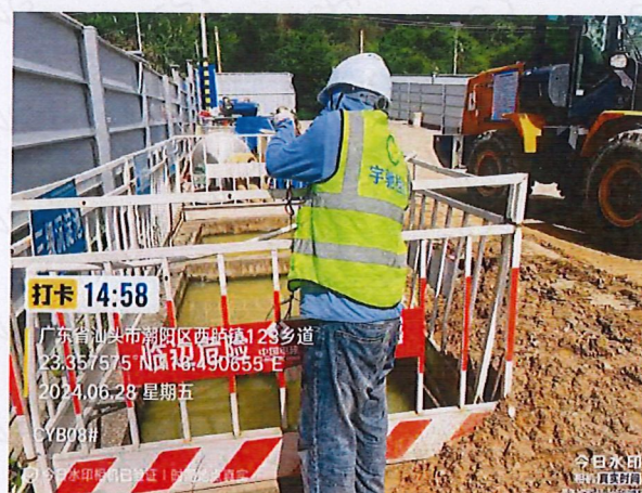
施工 5 标 CYB08#生产废水
