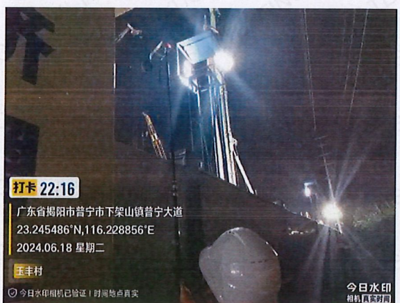
玉丰村（下架山泵站）南侧外 1 米 1#
