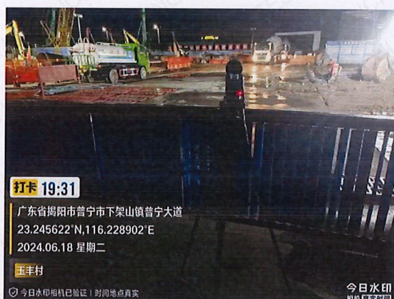
玉丰村（下架山泵站）南侧外 1 米 2#
